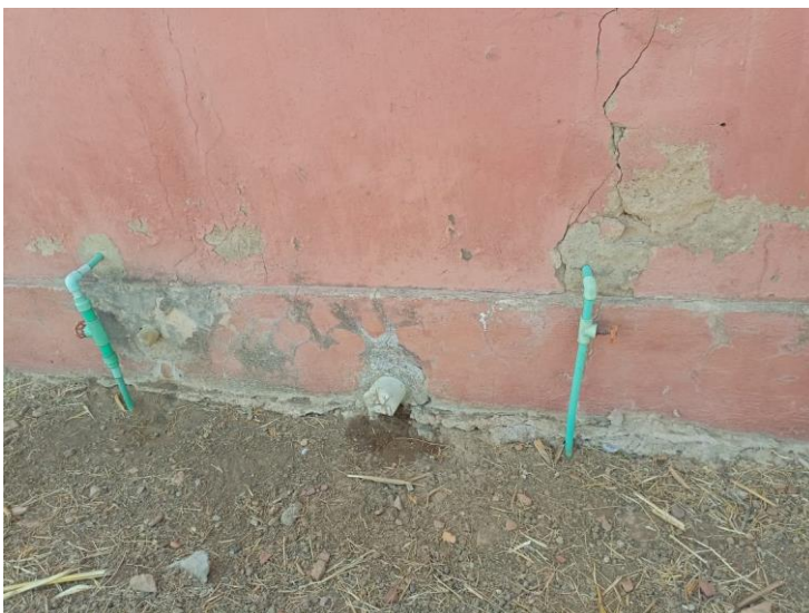
Sopra: lo scarico prima dell'intervento
